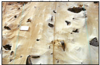
防砂シートの破損(イメージ)
